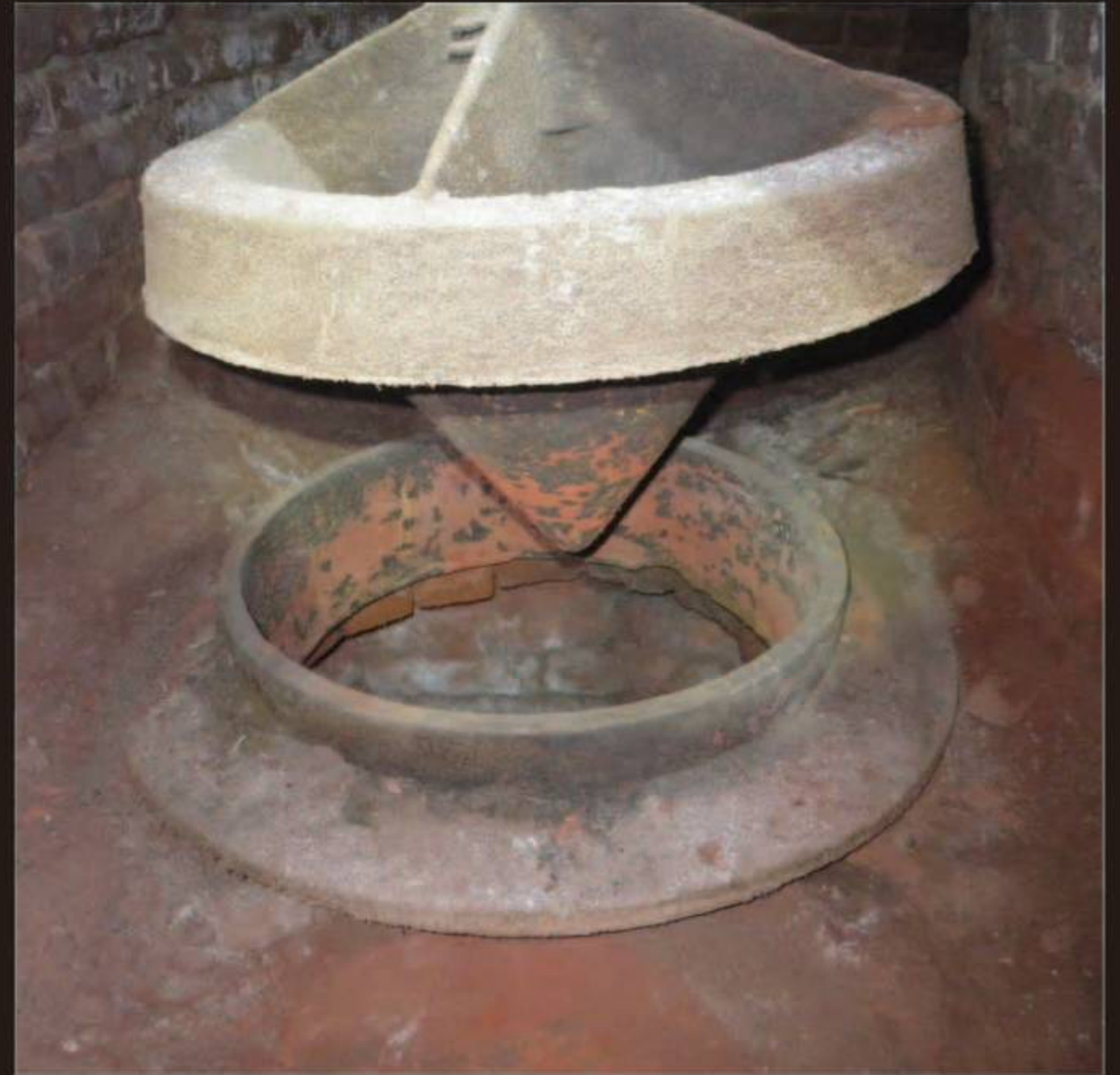
集煙道内部から見るダンパー Damper seen from inside the central flue
